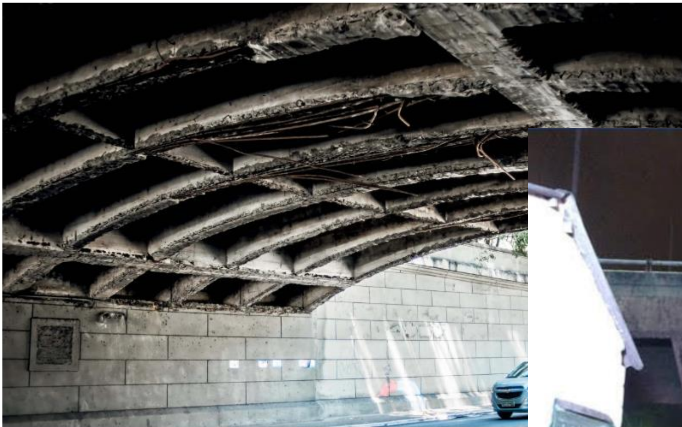
Teto de viaduto sobre a Avenida Pacaembu com ferragens à mostra: anos de f (Alexandre Battibugli/Veja SP)
