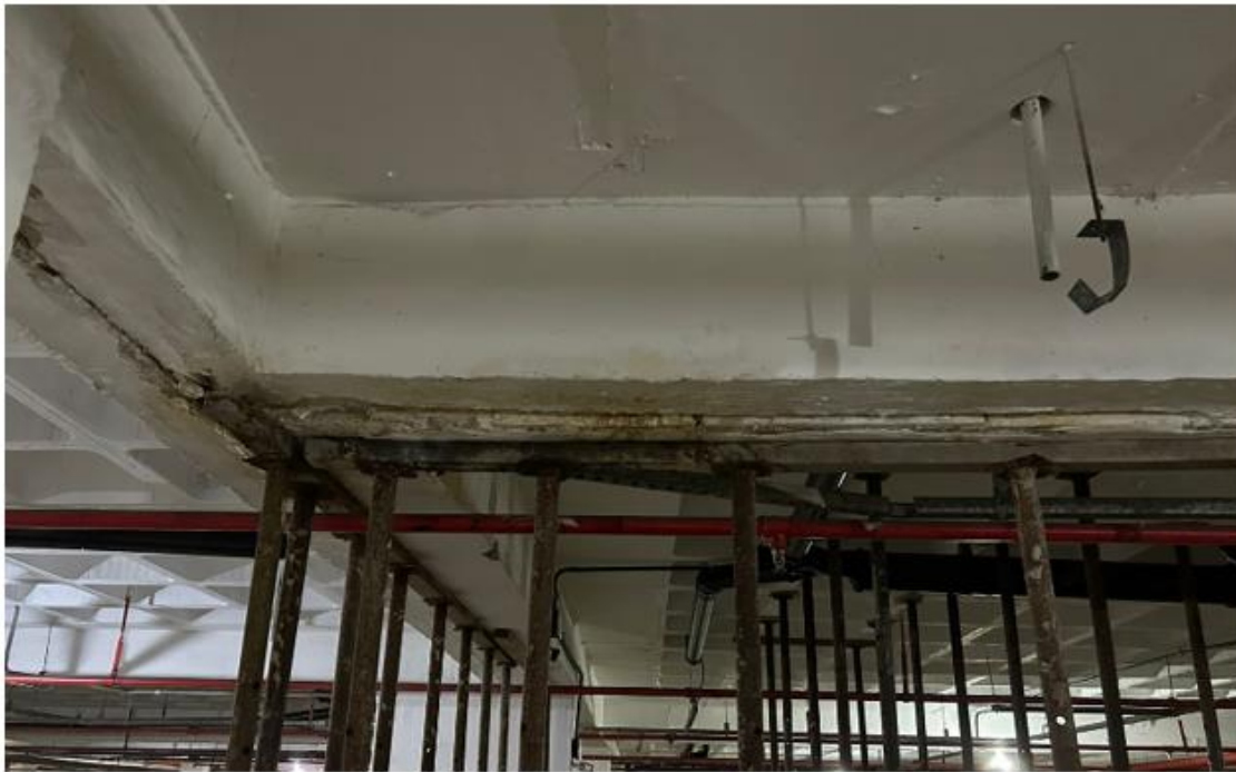
Figura 7 – No momento da visita estava chovendo e a água passava pelas juntas.
